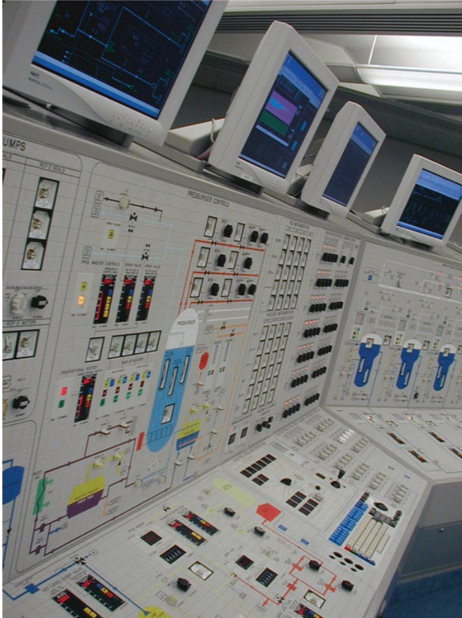
Рис. 1.1 ❖ Часть главного пульта управления водо-водяного реактора (PWR)
